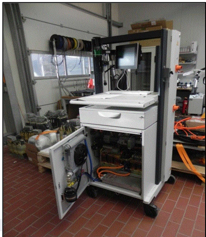
Bild 11: HV Arbeitsplatz für SoC und Balancing (Quelle: ZDK)
